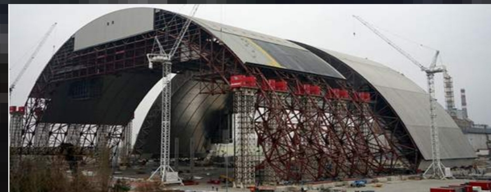
Sarkophag (im Bau) zur Abdeckung des zerstörten Reaktors von Tschernobyl (Quelle: Landeszentrale für politische Bildung Baden-Württemberg)
